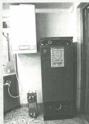
Calderas de gas JUNKERS y de gasoil ROCA y TIFELL
