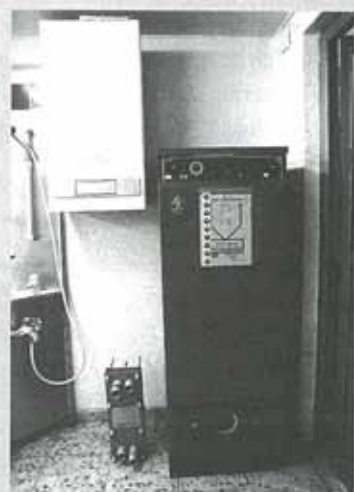
Calderas de gas JUNKERS y de gasoil ROCA y TIFEL
