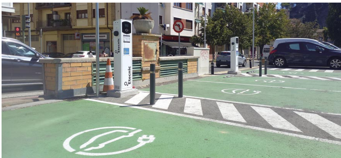
Los dos puntos de recarga instalados en el aparcamiento. Permiten cargar cuatro coches a la vez.
