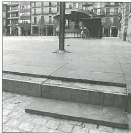
Losas sueltas, habituales en la plaza.
