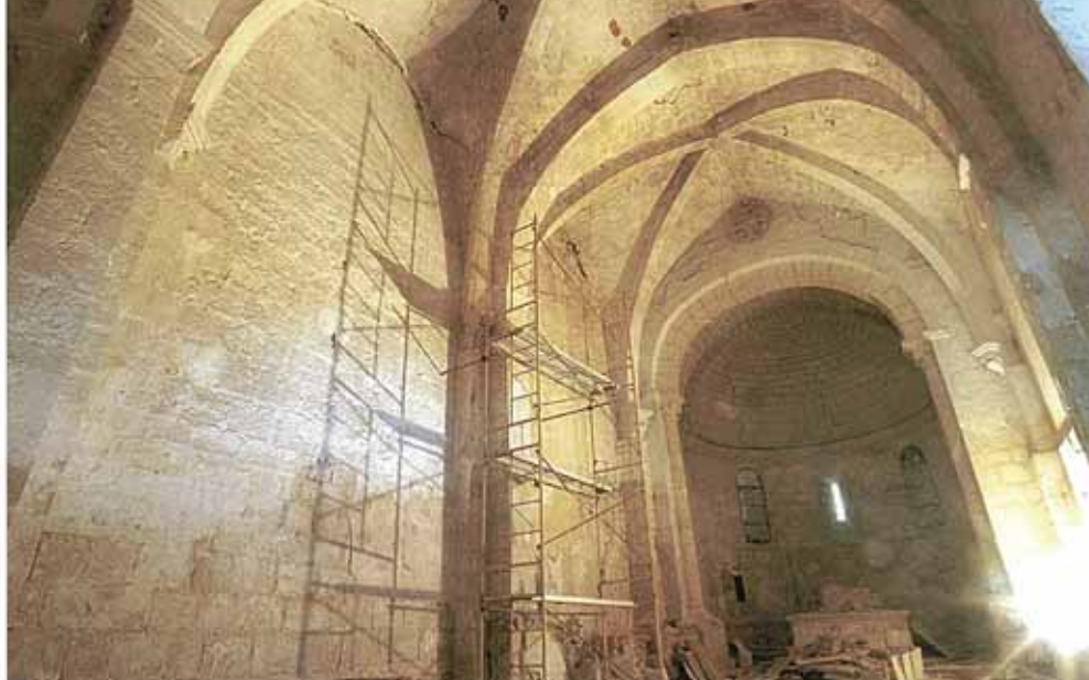
La bóveda se hallaba deteriorada debido a la falta de cubierta que ahora será colocada
