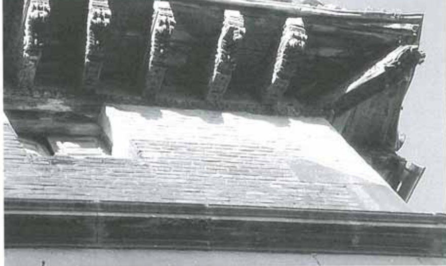
El edificio se encuentra en un estado muy precario
