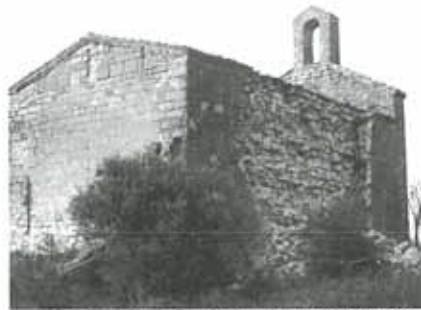
El desprendimiento afecta al lienzo exterior del muro norte de la ermita
