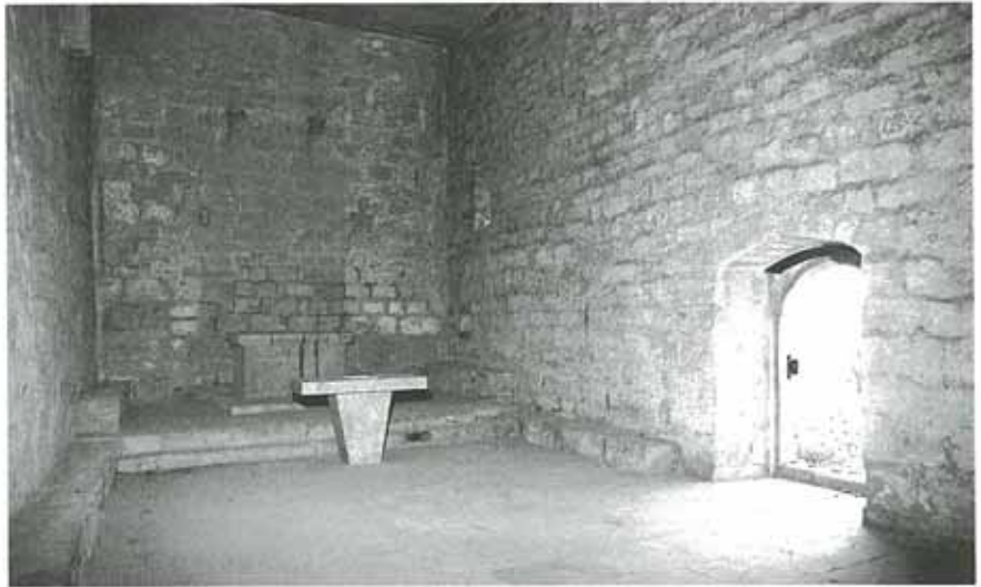
El interior de la ermita de San Miguel se verá dañado si se derrumbara también la cubierta
